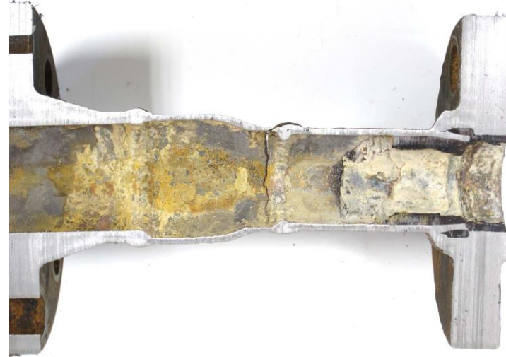
Corrosione da HF (Unità ALKY)
